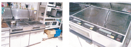
図 2 食堂に設置した IH クッキングヒーター
