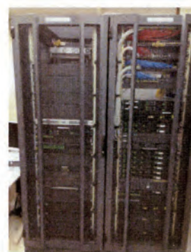
Fig. 2 更新後のサーバラック
