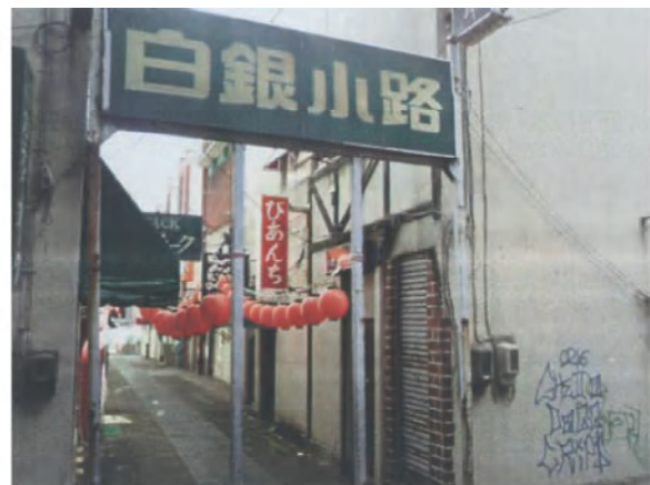
図2 落書き（建物の壁）の例
